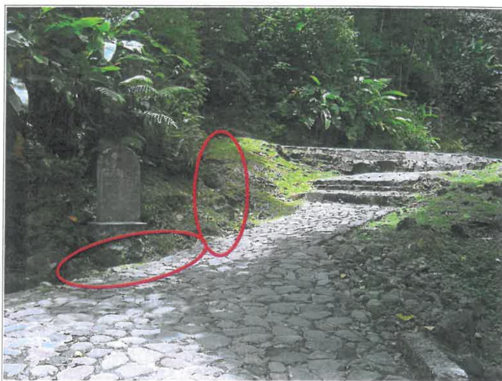
Voie d'eau à rénover sur le côté aval du bassin
