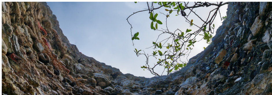
Intérieur du four à chaux, Îlet Fajou © Parc national de la Guadeloupe
